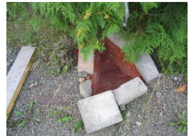
側溝に営巣。ネットを張り、殺虫剤
