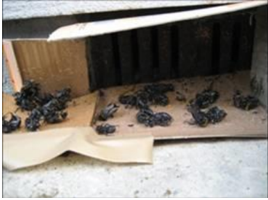
民家床下に営巣。出入りしている喚起口にひさしをつけ下に落とし、粘着シートで捕獲。
