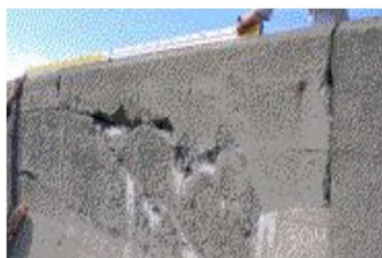
海岸保全施設(護岸) の損傷状況
