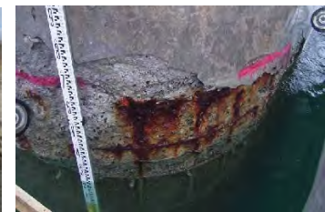
水門の老朽化状況
