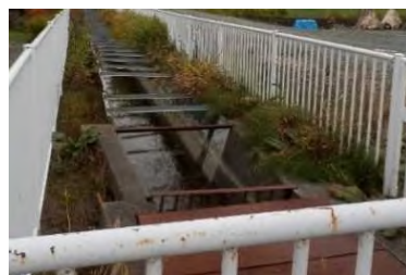
用水路の老朽化状況
