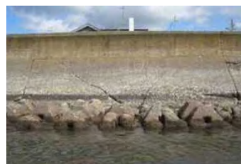
護岸の老朽化状況
