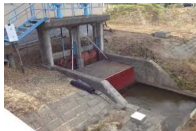
用水機場の老朽化状況
