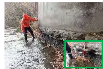
林道橋梁の点検状況 （河床低下による橋台基礎部の洗掘状況）
