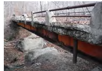
林道橋梁の老朽化状況 （主桁塗装の劣化、地覆の破損）
