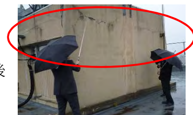
外壁の老朽化状況
