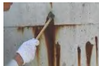
防災ダム(洪水吐) の劣化状況
