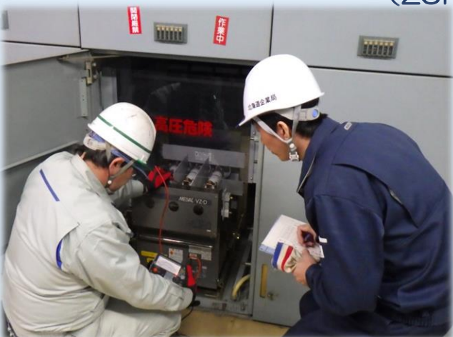
苫小牧地区工業用水道第一施設 (受電盤点検状況)
