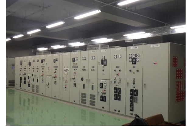
室蘭地区工業用水道（麓別ポンプ場受変電設備）
