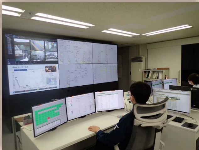
発電課発電制御室 (発電監視制御状況)
