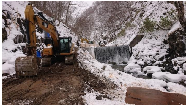
▲平田内川水力発電所
