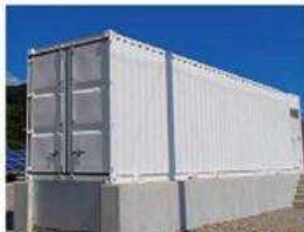
大型蓄電池で日照時間外の電力供給をサポート。
