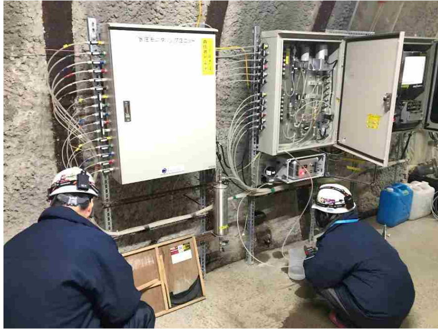
図 19 地下水の水圧・水質連続モニタリングの様子 (深度350m調査坑道)
