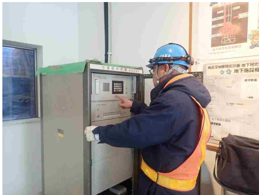
図 20 地震観測装置メンテナンスの様子 (西立坑アクセスルーム)
