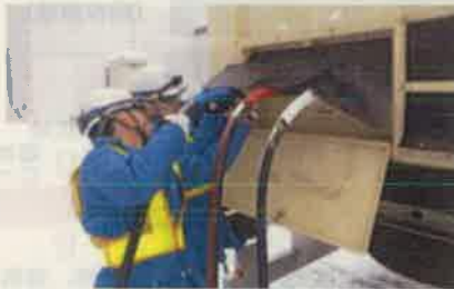
③代替給電訓練 交流電源喪失を想定し、可搬型代替電源車を起動し、受電設備へ接続する訓練
