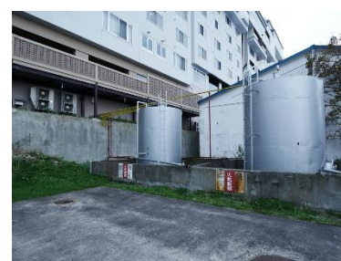
屋外貯蔵タンク（2基）
