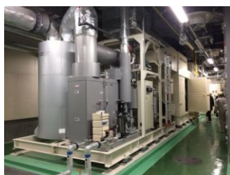
天然ガスコージェネレーションシステム
