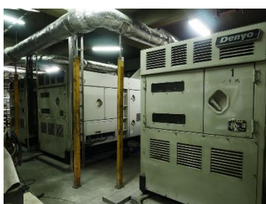
防音型エンジン発電機（4機）
