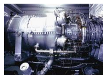
天然ガスタービン発電機 ((株)エナジーソリューション)
