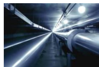
熱供給の導管（カルバート内部） ((株)エナジーソリューション)
