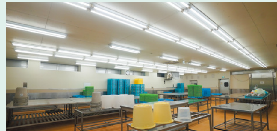
加工室の照明を蛍光灯からLEDに変更
