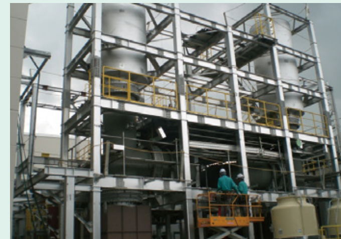
都市ガスを燃料とするガスエンジン2基、VOCと都市ガスを燃料とするガスタービン1基で発電し、廃温水や排ガスも活用
