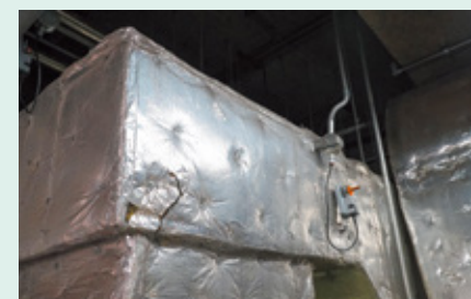
空調機は適正なCO2濃度になるよう、給気ダンパーを調整
