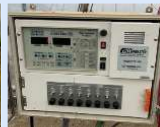
自動巻き上げ機の制御盤
