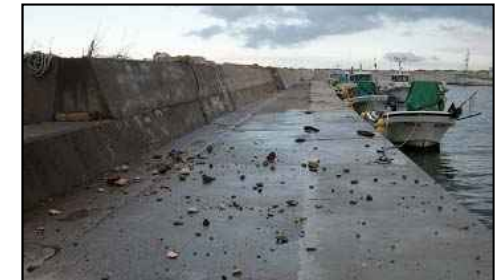
○北護岸越波状況 北護岸からの越波により、土砂が飛散。
