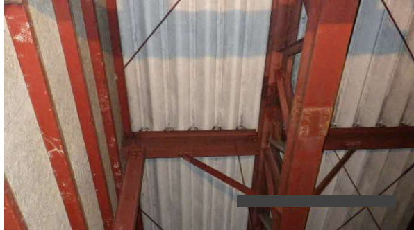
屋根用折板裏石綿断熱材
